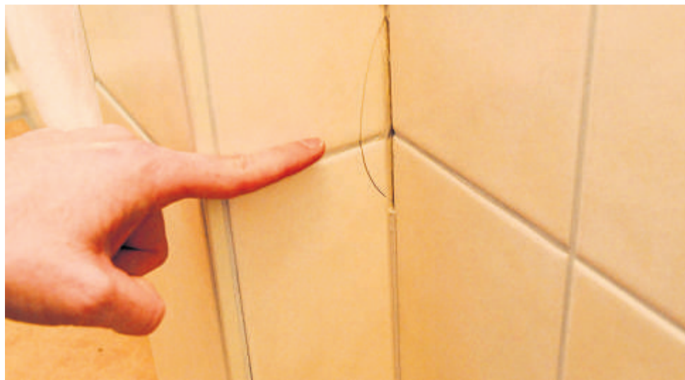
Unter anderem geht es bei den insgesamt 15 Baumängeln am Haus von Familie Angenendt um gerissene Fliesen im Bad wie diese. Foto: Hayretin Özcan
