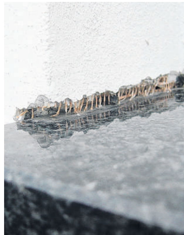
Durch Schäden an der Fassade wie hier kann Feuchtigkeit eindringen. Seit vier Jahren wird darüber Beweis erhoben. Foto: privat
